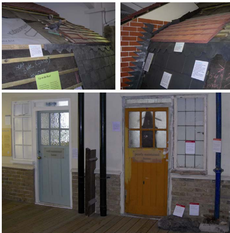
Fig. 10. In queste singolari foto sono rappresentate alcune delle cause che concorrono al deterioramento delle abitazioni e le modalità corrette di manutenzione.
