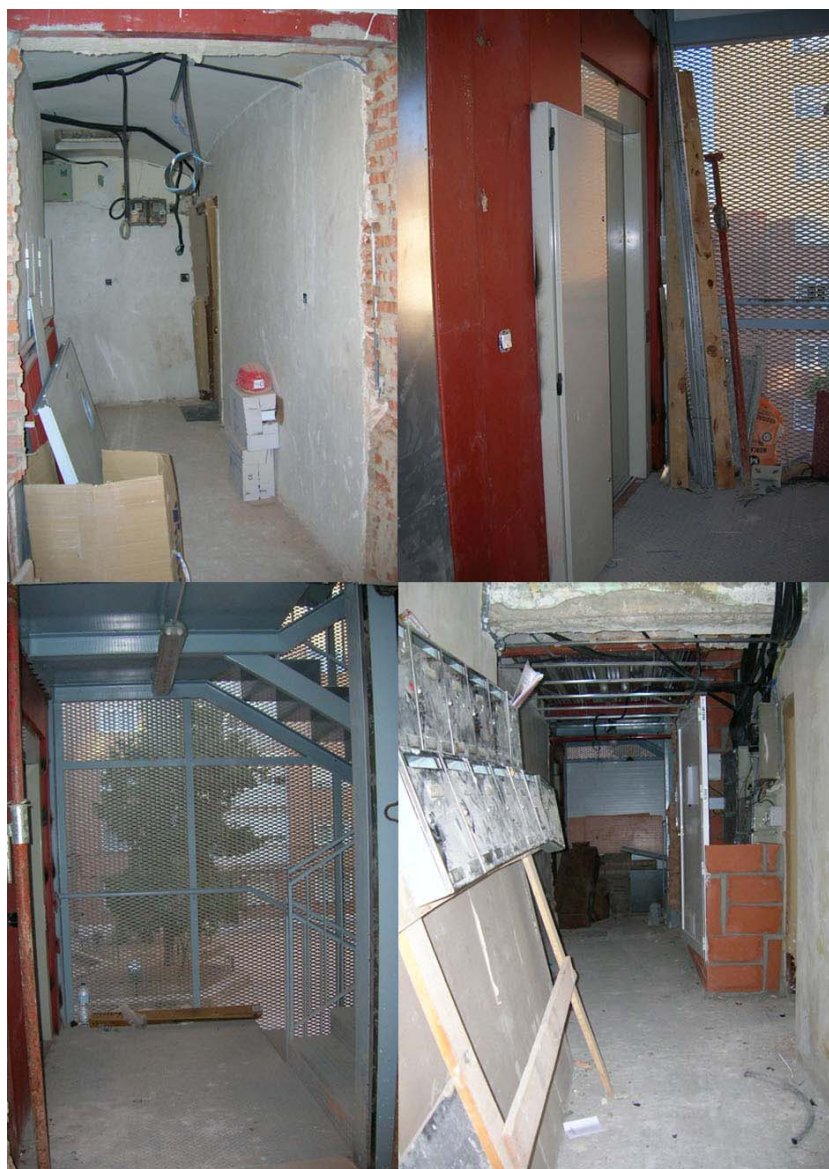
Fig. 20. Alcune immagini dei lavori che si stanno eseguendo all'interno degli edifici del Polígono de 18 de Julio per l'installazione dell'ascensore e delle nuove scale metalliche. Foto scattate durante un periodo di ricerca, agosto 2010.
