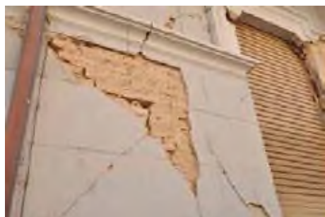
Fig. 3.7.3: Danno per lesioni da taglio
