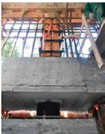
Foto 3: Vista di un isolatore inserito al di sotto del portico
