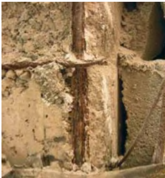
Fig. 3.6.2: Immagine che mette in luce carenze strutturali dovute alla perdita del coperifero
