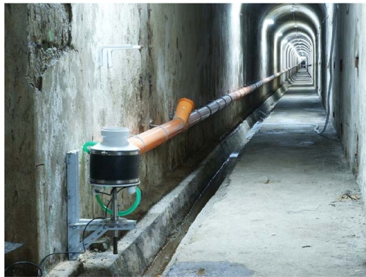
Figura 4.17: Immagine dell' inclinometro PTNO; in particolare si vede il sensore NN con il tubo rivolto verso sud.
