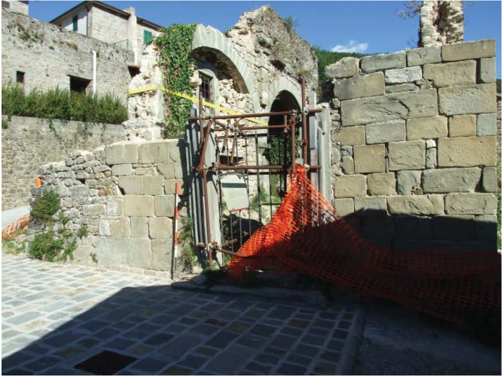
Fig. 13. Conseguenze del terremoto sulle strutture edificate pluristratificate negli abitati rurali: la pieve di Regnano (Casola, MS)
