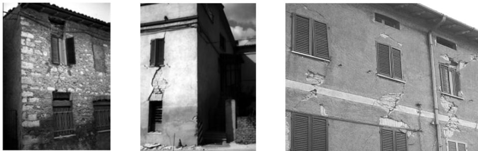
Figura 4.18 – Esempi di danni da sisma in edifici in muratura ordinaria
