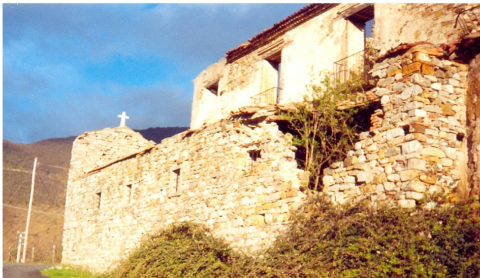
Le rovine della chiesa di Arioso in Basilicata costruita vicino il palazzo baronale prima del crollo totale degli ultimi anni.
