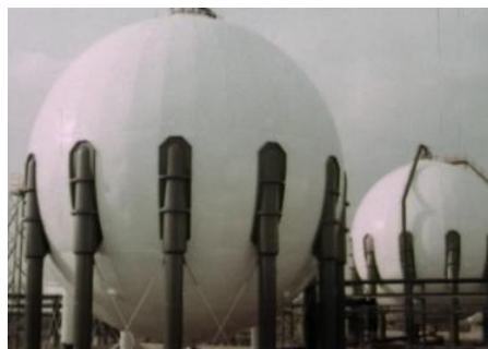
Le sfere-deposito del gpl
