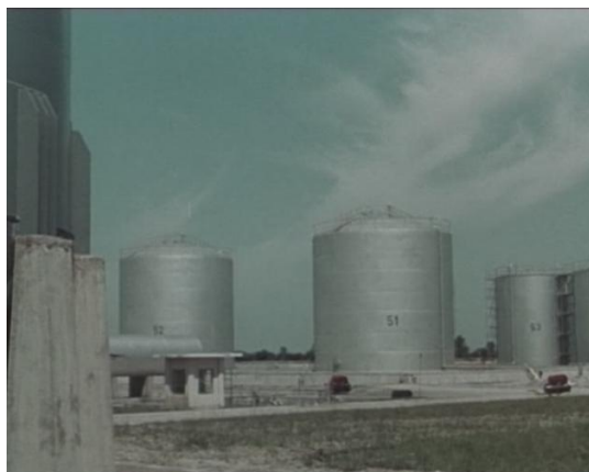
I serbatoi della centrale ( Pozzo 18 profondità 1650 )
