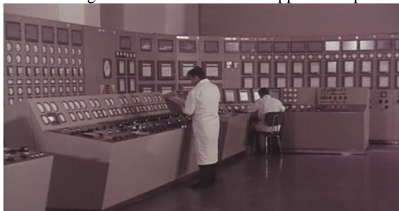
La sala controllo della centrale
