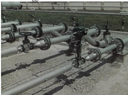
Particolare della stazione di partenza del metano
