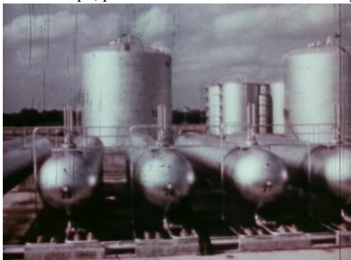
Panoramica dei serbatoi di Cortemaggiore
