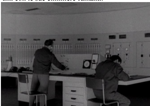
Sala di controllo dell'oleodotto
