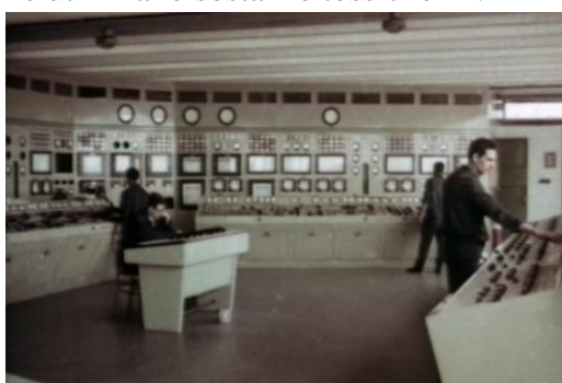
Sala comandi dello stabilimento di Gela ( Il gigante di Gela )
