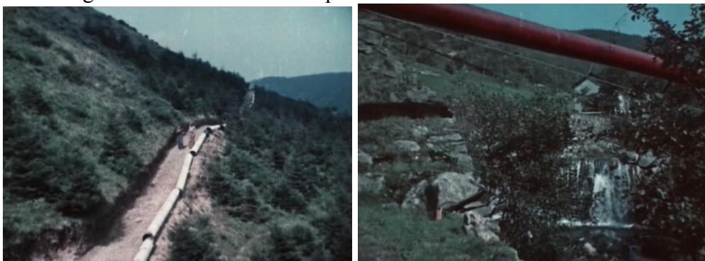
Il "tracciolino": la strada del metanodotto ( Arterie d'acciaio ) Metanodotto aereo sul corso d'acqua ( Arterie d'acciaio )
