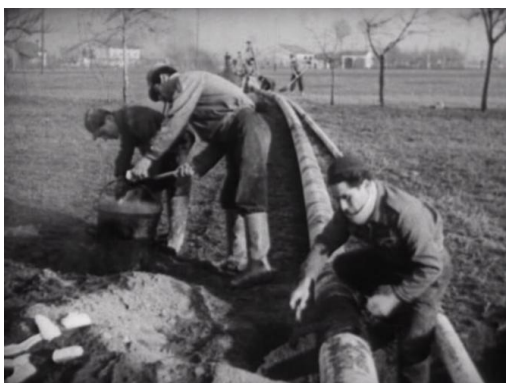
Impermeabilizzazione "artigianale" ( Le vie del metano )
