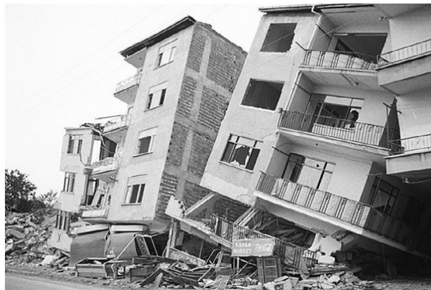
Figura 2.5: Meccanismo tipo 1 - Terremoto di Cotabato, Filippine 16 Agosto 1976
