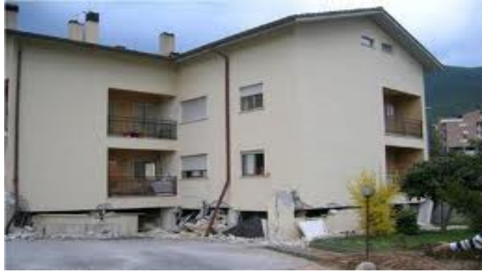
Figura 2.9: Meccanismo tipo 3 - Terremoto dell'Aquila, Italia – Aprile 2009
