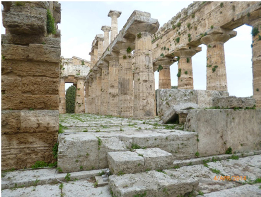
Figura 2.2.11: Ingresso della cella del tempio di Nettuno, vista sud-est (Ispezione in sito).
