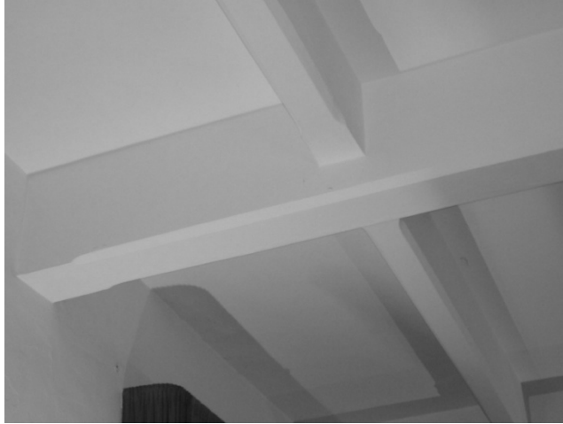
fig. 172: particolare di un nodo del solaio a nervature incrociate in conglomerato cementizio armato posto a copertura dell'attuale salone di rappresentanza dell'Associazione "Soccorso Amico".
