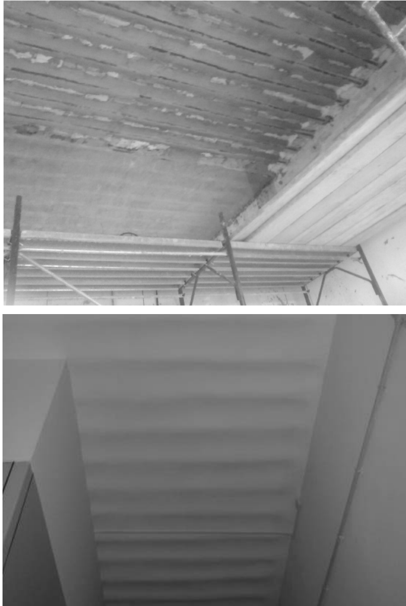
figg. 277: operazioni immediatamente successive alla posa in opera delle lamine in fibra di carbonio (in alto) e vista del solaio come appare oggi dopo l'intervento (in basso).
