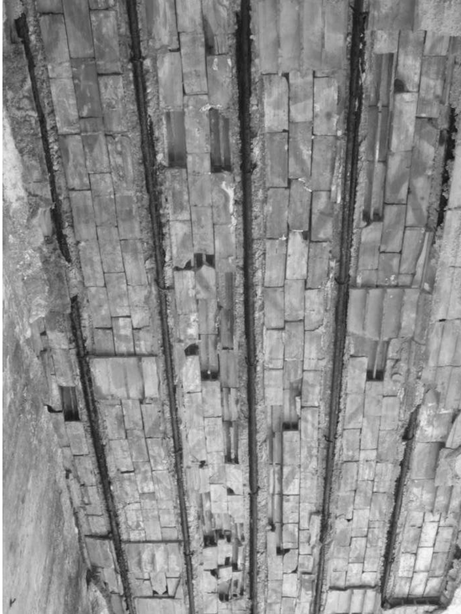
figg. 256 (immagini pp. 542 e 543): degrado di alcuni solai di copertura del Pontificio Seminario Regionale "Pio XI" (scheda B.4).
