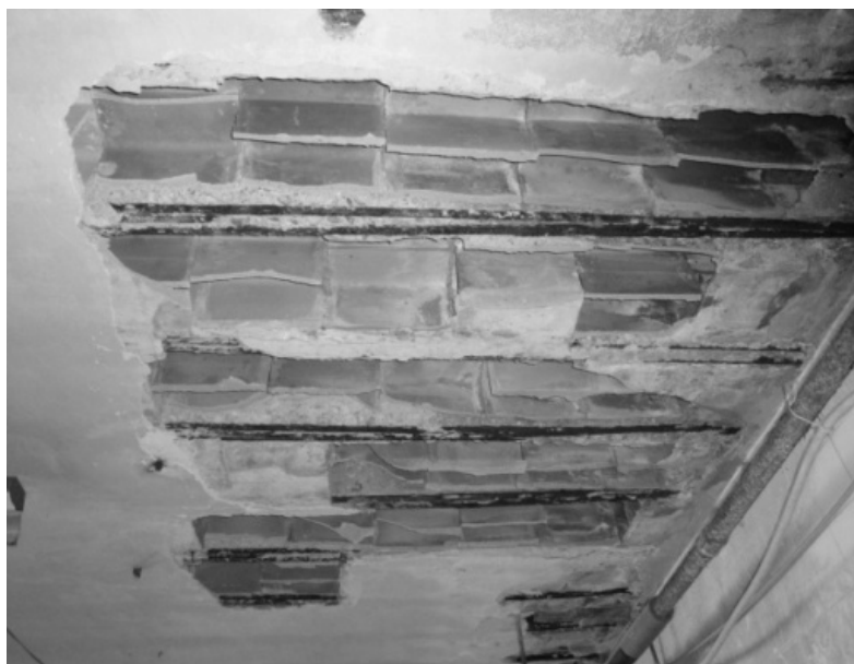
fig. 225: immagine di uno dei solai dei due padiglioni aggiunti che si presenta in uno stato di forte degrado.
