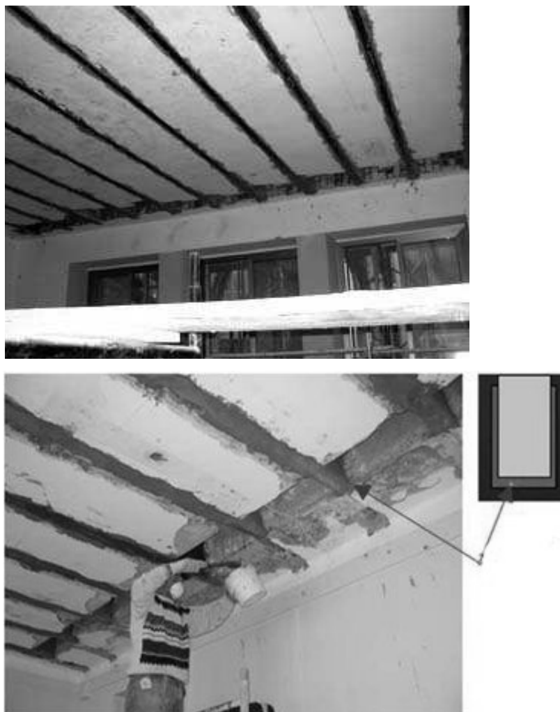
figg. 274: rinforzo dei travetti mediante l'applicazione di lamine in CFRP all'intradosso (in alto). È importante notare che nella zona vicina all'appoggio (fascia piena), si è proceduto all'asportazione dei primi blocchi di ogni filare in modo da consentire la fasciatura delle testate e delle superfici laterali dei travetti con strisce di tessuto in CFRP (in basso) (da Becco V., Recupero di un solaio in latero-cemento in "La gazzetta dei solai" - anno 5, n. 44, a cura della sezione solai dell'Audil Assolaterizi - Mensile di informazione tecnica sui solai in laterizio).
