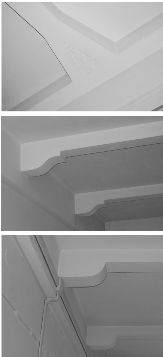
figg. 178: particolari degli appoggi delle travi emergenti ubicati in alcuni locali del secondo piano, nell'ordine: segreteria; ufficio amministrativo; stanza del G.I.P.
