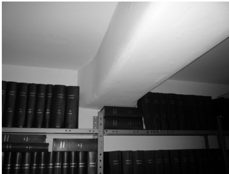
figg. 196: vista del solaio a nervature parallele del locale deposito e particolare di una delle nervature che presenta un aumento di sezione in corrispondenza degli appoggi per meglio resistere agli sforzi generati dalle sollecitazioni da taglio.
