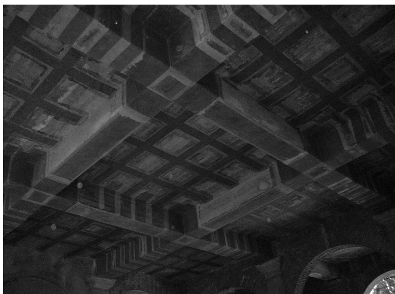
figg. 279: alcune immagini delle fasi dell'intervento di rinforzo strutturale con CFRP - fase immediatamente precedente alla riparazione dei travetti in conglomerato cementizio armato per la successiva posa in opera dei tessuti in fibra di carbonio (in alto) e tessuti posti in opera (in basso).
