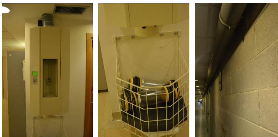
Fig. 3.35: Impianto di trasporto pneumatico.
