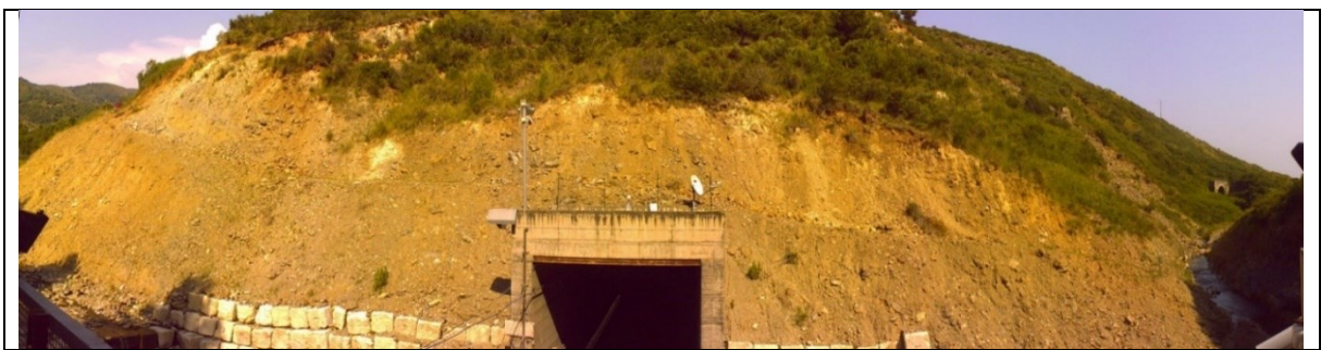
Figura 45 - Visione panoramica del versante in frana; sistemazione delle rocce al disopra della galleria ferroviaria.
