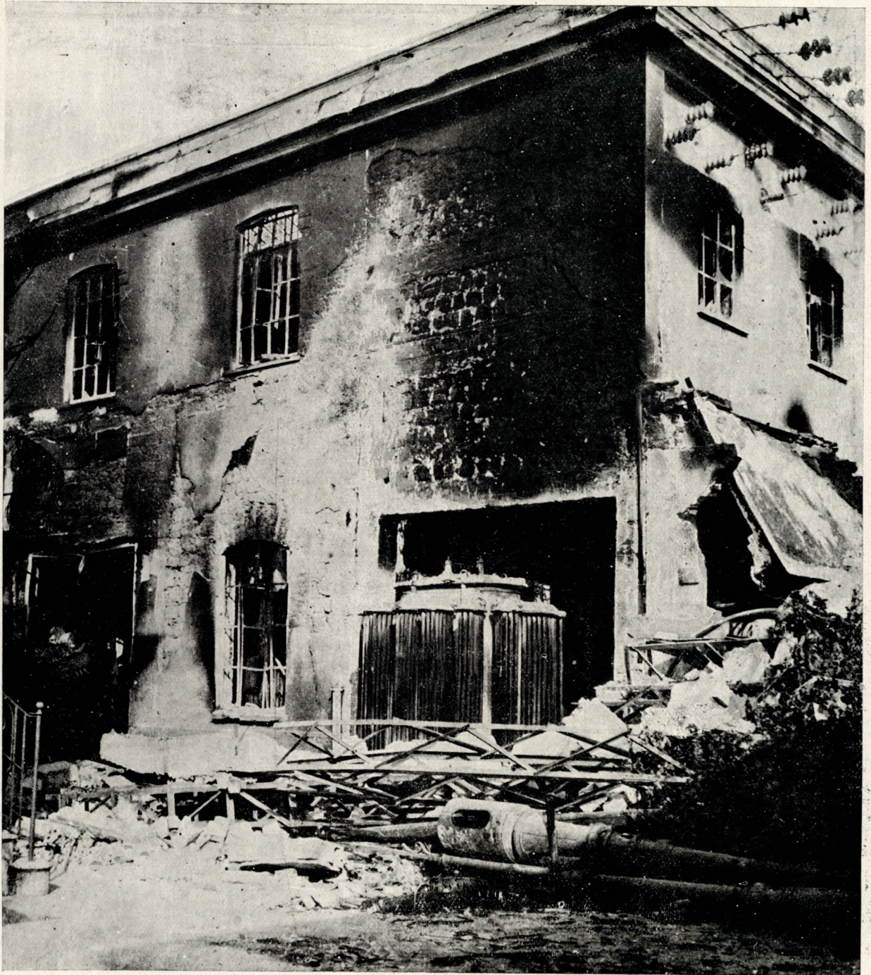
SEDAC - Via Orti - Salerno — SOTTOSTAZIONE A 30.000 VOLT
