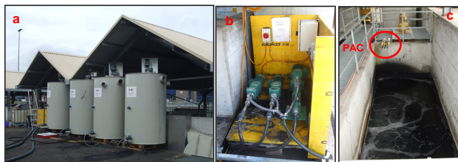
Figura 6.10 (a) Serbatoi per lo stoccaggio del PAC, (b) pompe dosatrici del PAC, (c) immissione del PAC nella vasca di contatto
