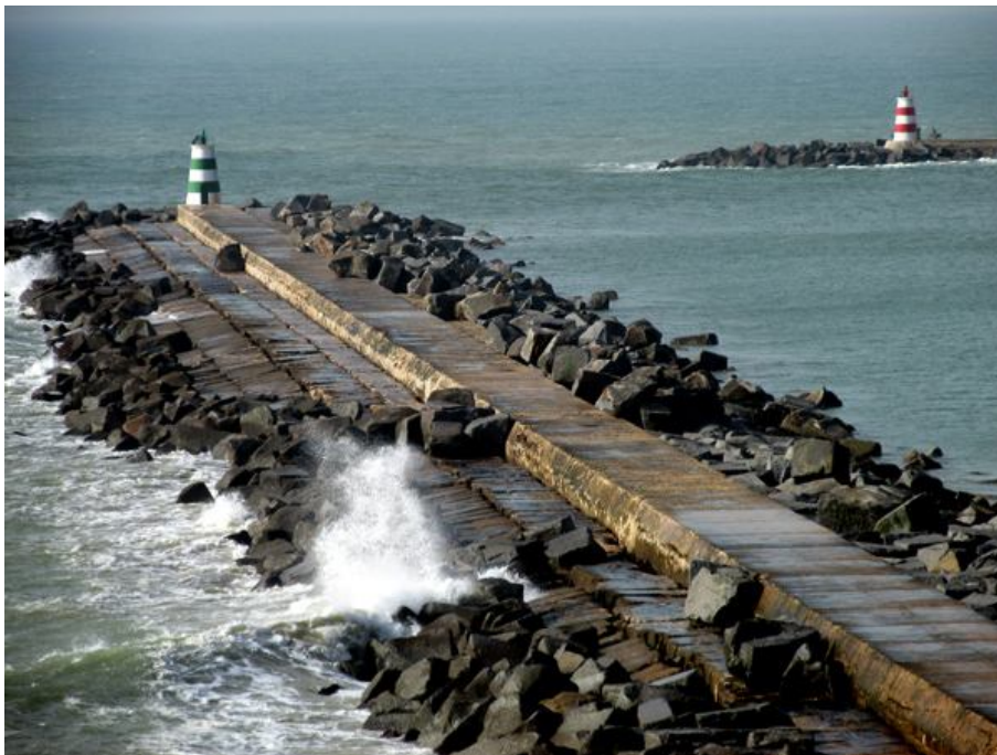
Figura 2.26 Danneggiamenti sul molo di levante del porto di Portimão - Portogallo
