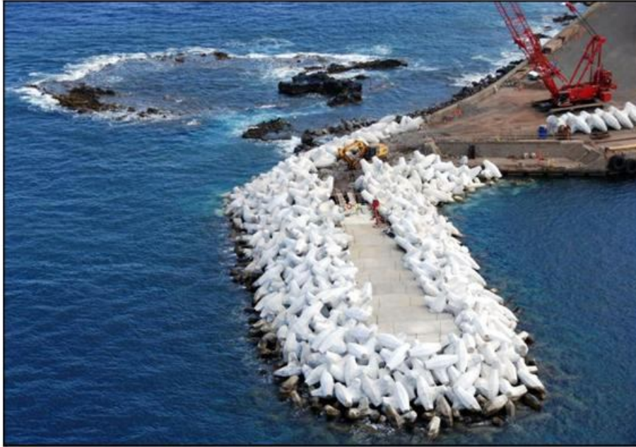
Figura 2.18 Diga a scogliera con Core-loc al porto di Kaunapau, Isola di Lanai, Hawaii.
