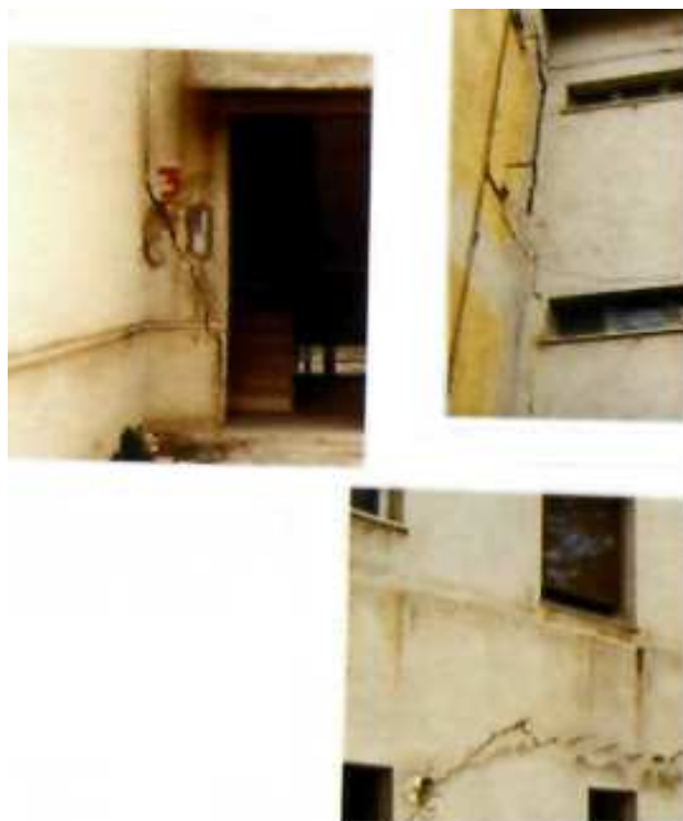
Figura 6.29. Quadro fessurativo delle Case popolari (Gullà, 2003).
