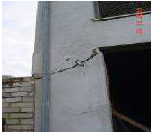
Figura 4.1. Esempio di danno strutturale.
