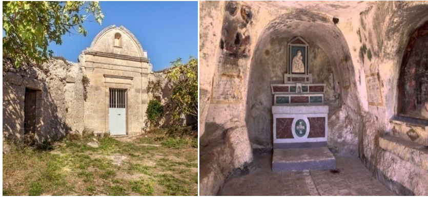
Figura 75. Facciata e interno della chiesa Madonna dei Derelitti: patine biologiche sulle pareti
