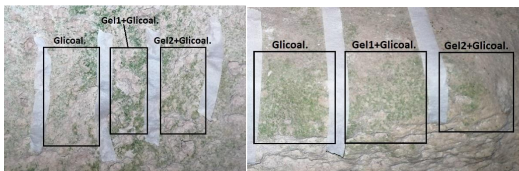
Figura 57 . Aree trattate sulla parete verticale (a sinistra) e sulla parete orizzontale (a destra)
