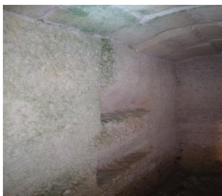
Figura 17. Ipogeo di San Pietro Barisano: parete trattata
