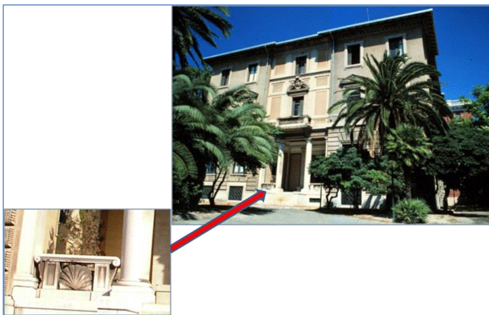
Figura 13. L’edificio sede del CNR –IRSA di Taranto e particolari del degrado della facciata
