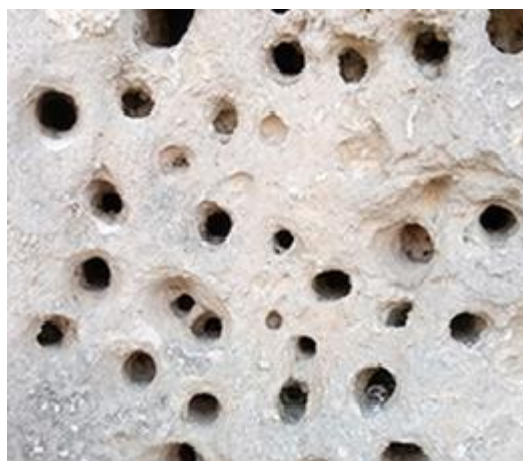
Figura. 14. Alveolizzazione mista a erosione differenziale nella calcarenite di gravina dei Sassi di Matera (Bonomo et al., 2020).
