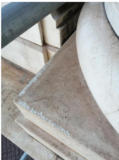
Figura 25. Particolare del piedistallo di una colonna della facciata dell'Istituto CNR-IRSA di Taranto
